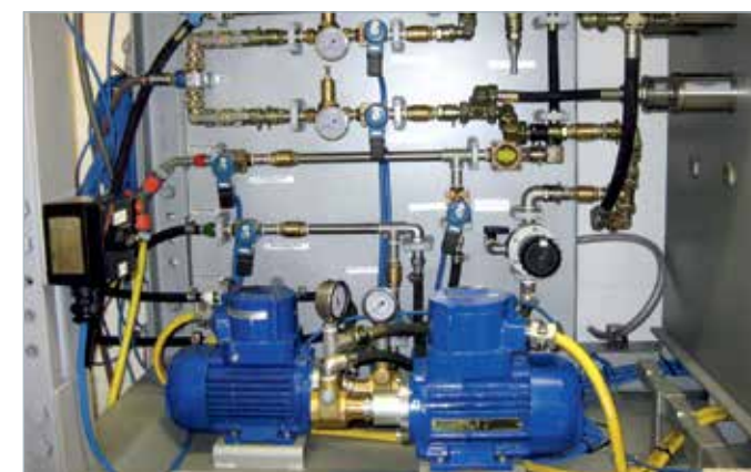
Control de sistemas hidráulicos
