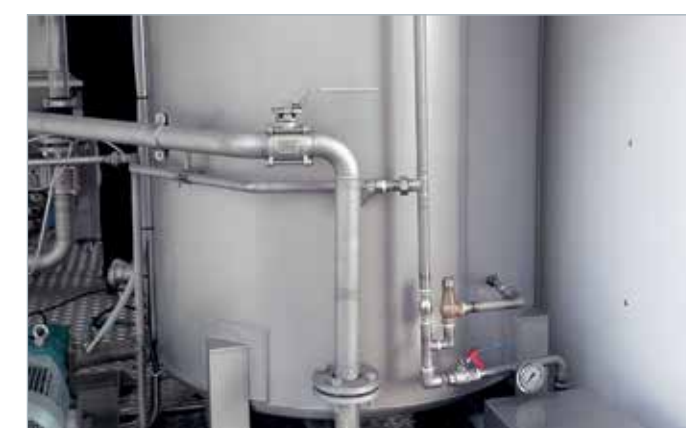
Tratamiento de agua
